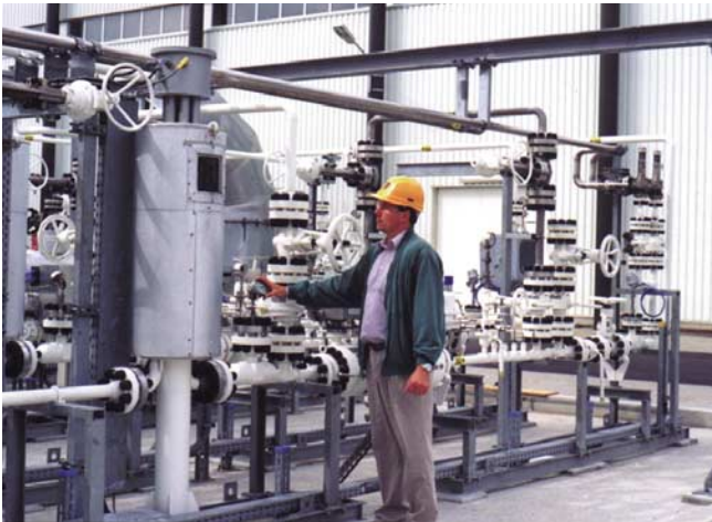
Gasdruck-Regelstation mit Erdgasvorwärmer 35 kW, Baureihe III Natural gas pressure regulation station with preheater 35 kW, series III
